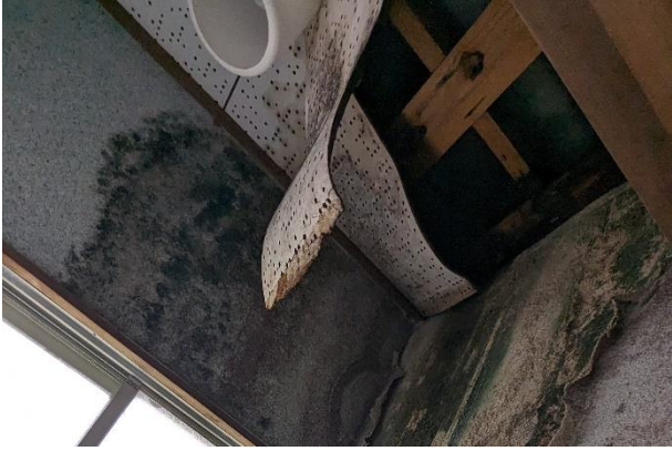
雨漏り跡 (トイレ)
