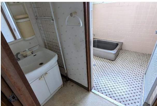
脱衣所・浴室
